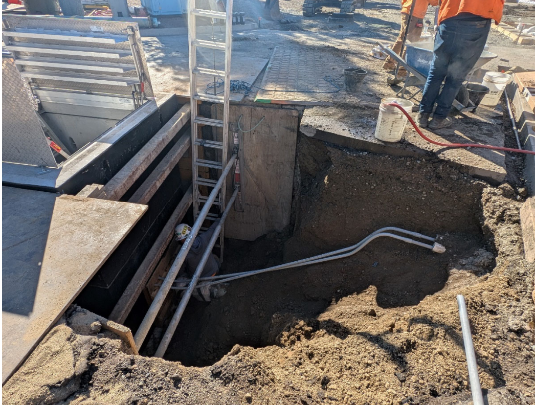
Flow Meter Conduits
